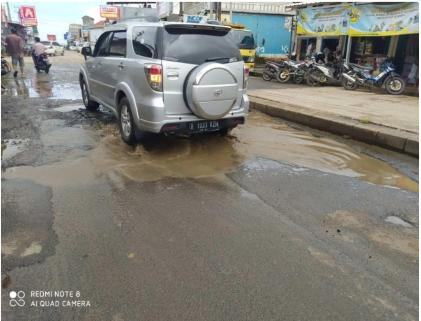
Nampak jalan protokol Malingping rusak berlubang dan digenangi
